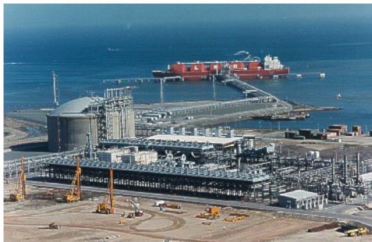
LNG Ship Unloading at Terminal
